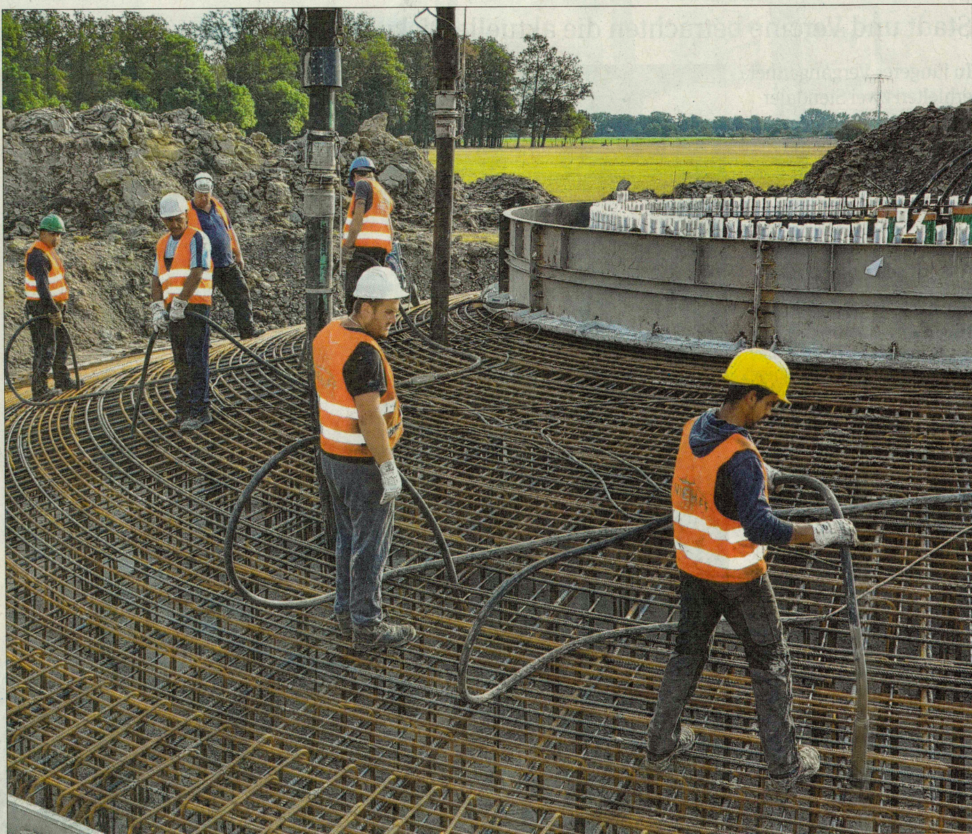
Schwere körperliche Arbeit erfordert das Heraustreiben der Luft aus dem Beton, nachdem dieser in das Fundament für die Windkraftanlage gepumpt wurde. Das Windrad gehört zu den drei neuen Anlagen, die nahe der Osterburger Stadtrandsiedlung entstehen. Fotos: Regina Urbat
