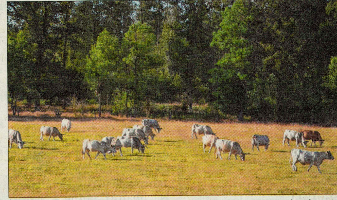
Kühe weiden, während unmittelbar nebenan der neue Windpark entsteht. Die Wiese kann auch künftig als Weideland genutzt werden.
